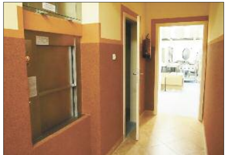
Tuż przed wejściem do nowoczesnej kuchni zlokalizowano windę spożywczą
